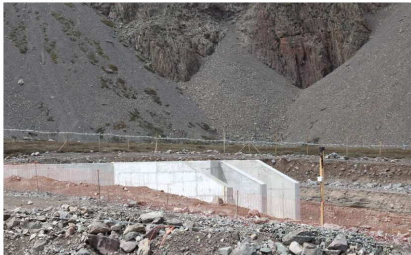
Figura N°15.2. Bocatoma estero Colina (parte superior de la figura anterior).
