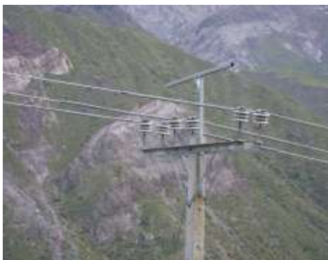
Foto 3: Medidas para evitar la electrocución en aves aplicadas en un tendido de media tensión la cuenca del río Portillo
