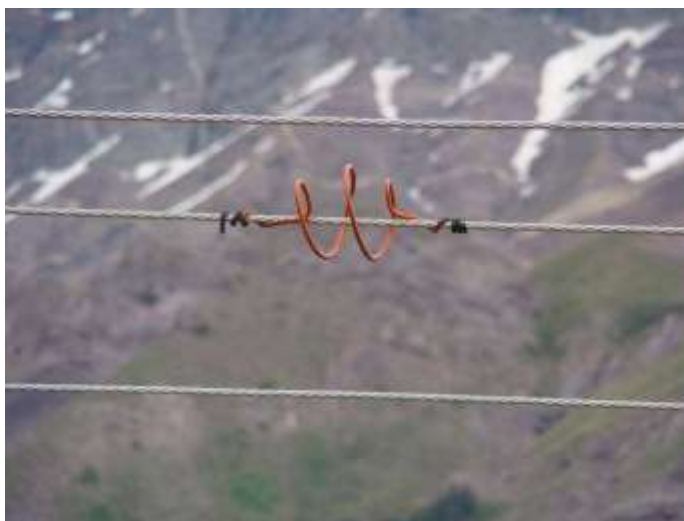
Foto 4. Espiral colocado en cables de tendido de media tensión en la cuenca del río Portillo
